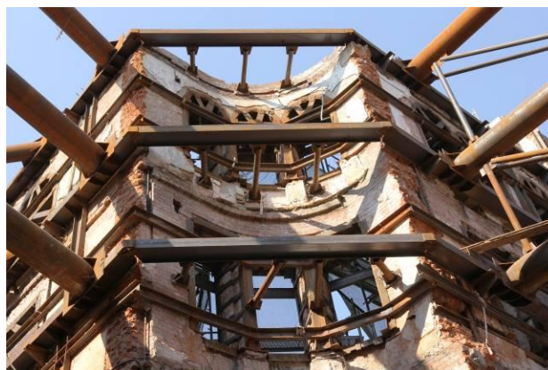
Рис.5. – Фотофиксация системы стяжек удержания фасада [10]
