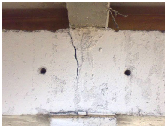
Рис. 2. – Трещина в железобетонной балке
