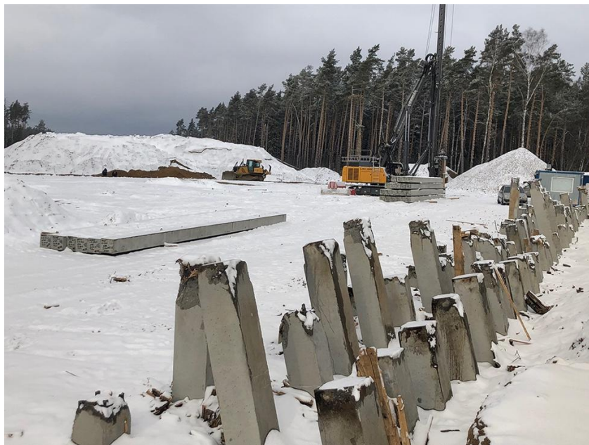
Рис. 1. – Фундамент из козловых свай путепровода трассы М-12 в районе д. Полтево – д. Дятловка (съемка январь 2022 г.)
